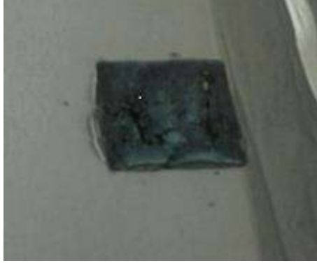
Şekil 11. Tek katmanda oluşan çatlaklar ve çarpılmalar
